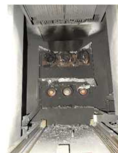
盤内開口部の状態(遮断器室)
