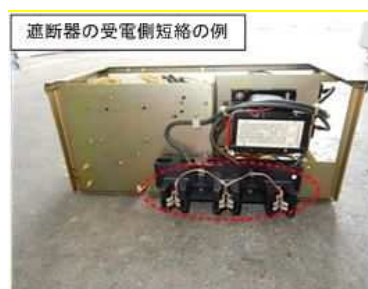
図 4.5.3 遮断器の短絡箇所 (C/C試験時)
