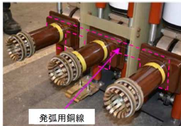
発弧線の設置状況(遮断器2次側端子)
