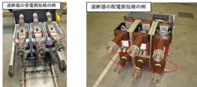
図 4.5.1 遮断器の短絡箇所 (M/C試験時)
