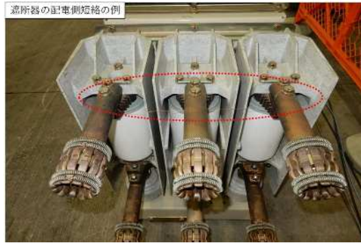
図 4.5.4 遮断器の短絡箇所 (M/C (D/G) 試験時) (非常用発電機に接続される電気盤)
