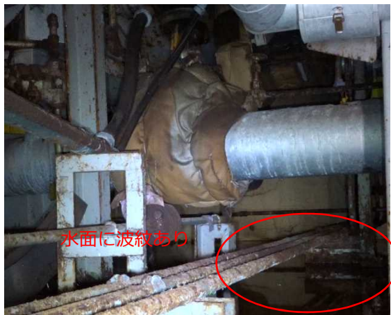
主蒸気系ドレン配管
