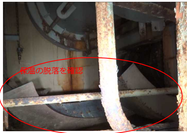
主蒸気配管 B
