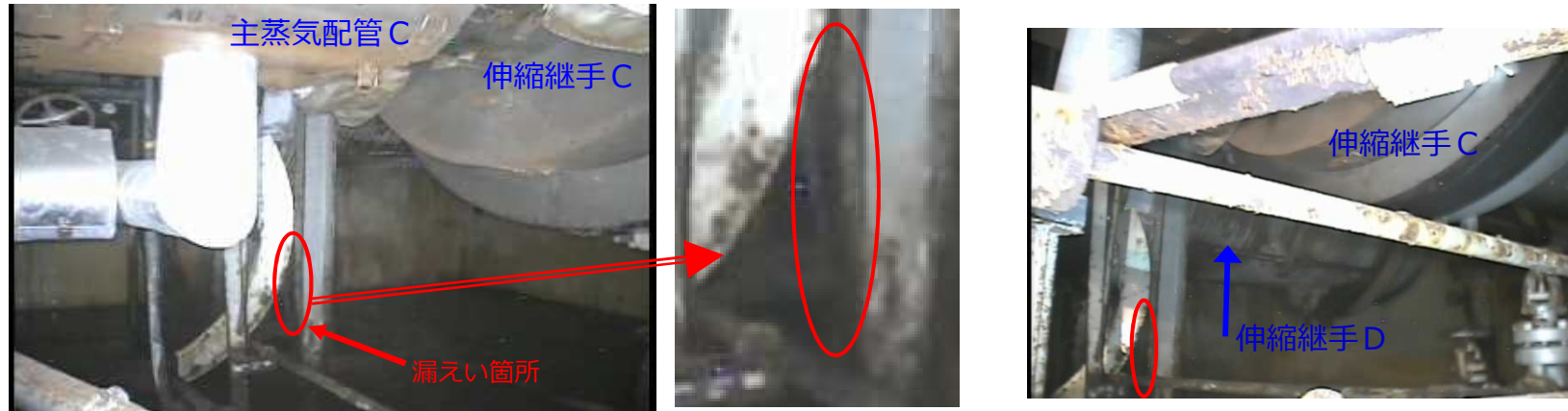
主蒸気配管D（主蒸気配管Cの奥側）
