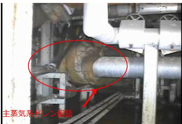
主蒸気系ドレン配管
