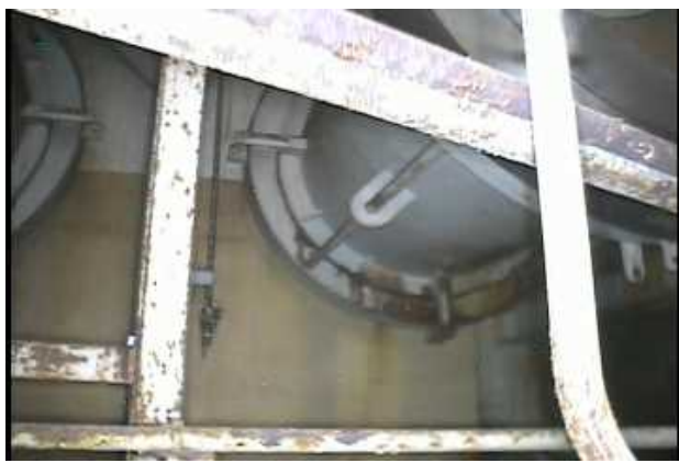
主蒸気配管 B
