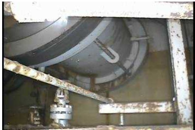
主蒸気配管 C
