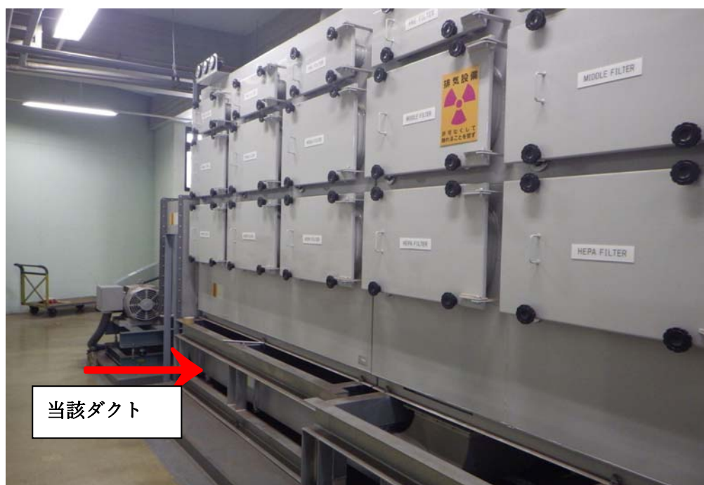
写真1 主排気設備(排気チェンバ)
