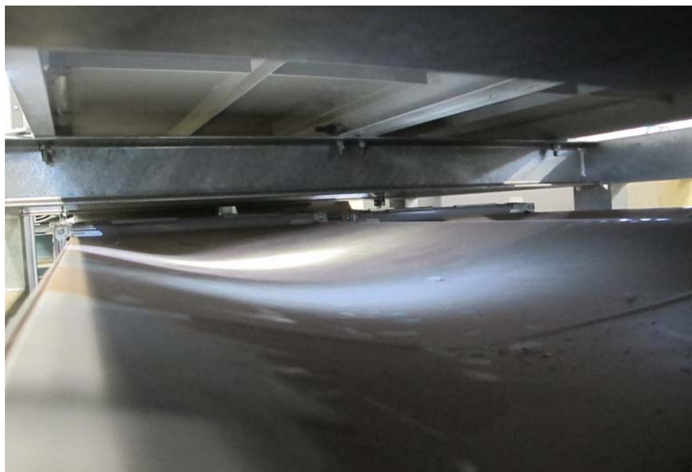
写真2 ダクト上部の変形(運転時)
