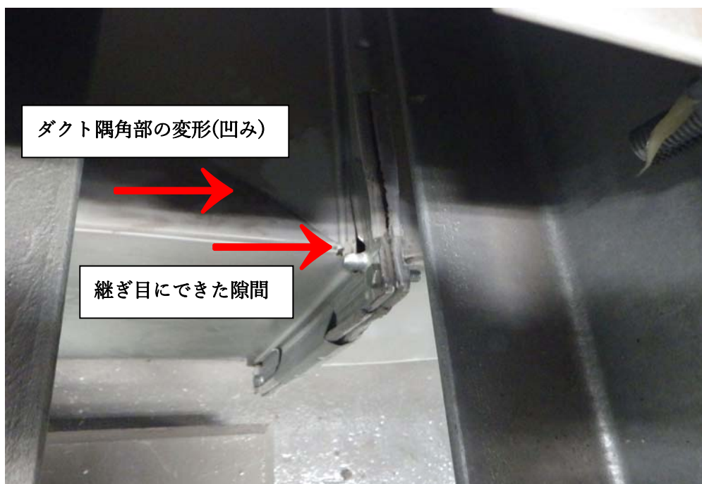
写真4 ダクトの継ぎ目にできた隙間とダクト上部隅角部の変形
