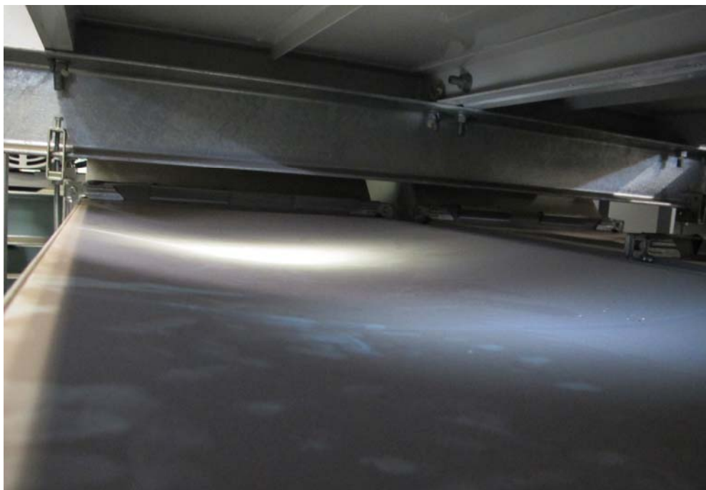
写真3 ダクト上部（非運転時）
