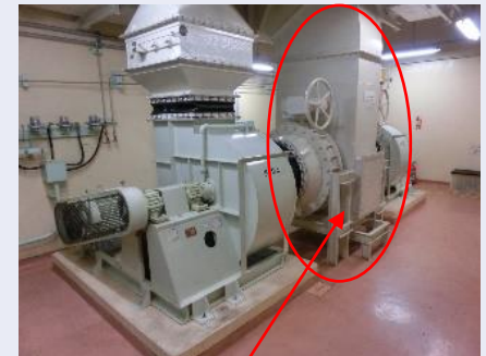
2基の排風機の上にダクトがあり、耐火壁等の設置は不可能
