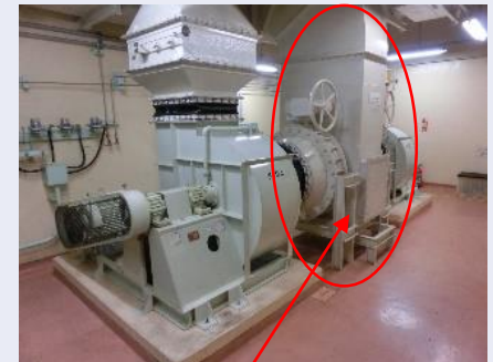
2基の排風機の上にダクトがあり、耐火壁等の設置は不可能
