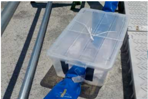
【耐圧ホース接続箇所】
