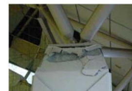
立体トラス支持部・柱頭コンクリートの破損
