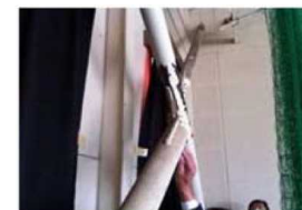
鋼管ブレース中央継ぎ手部の座屈
