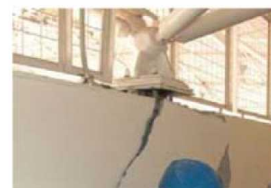
屋根支安アンカー部の破損
