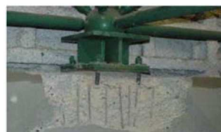
立体トラス支持部・構造全体の破損
