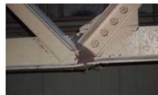
ブレース交差点の局部変形
