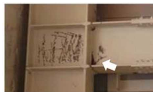
梁端部ウェブ材の破断
