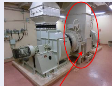
2基の排風機の間にはダクトがあり、耐火壁等の設置は不可能
