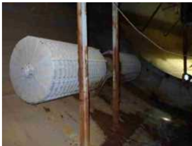
③CS系配管ストレーナを撮影
