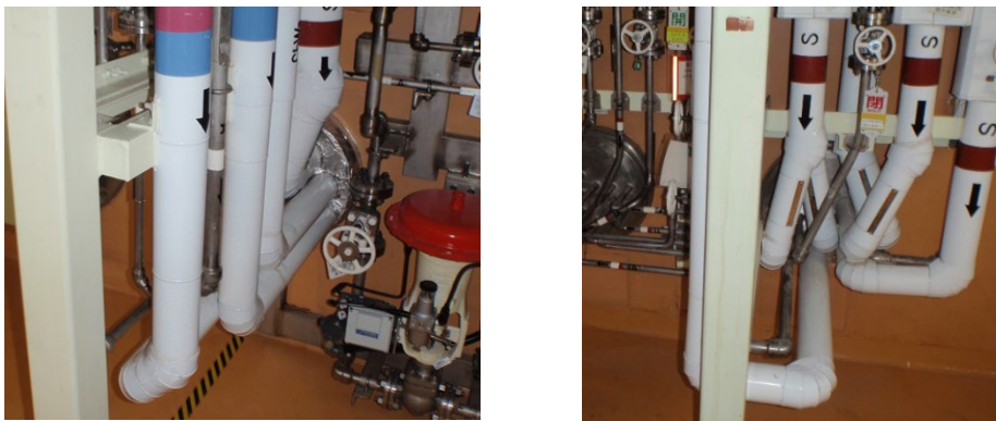
図-1 配管分岐室におけるセル貫通部の蒸気配管等の設置状況
