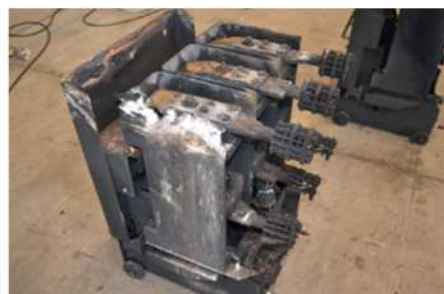
遮断器室アーク発生、アーク火災有、消火後の遮断器の様子
