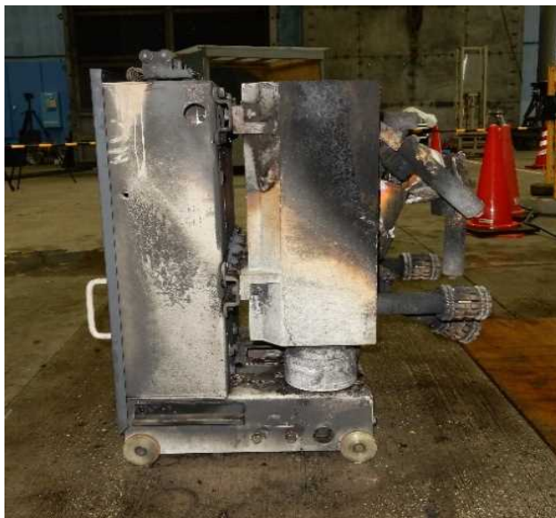
遮断器室アーク発生, アーク火災有, 消火後の遮断器の様子
