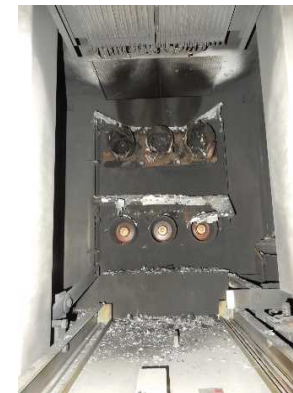
盤内開口部の状態(遮断器室)
