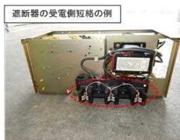
図 4-11 遮断器の短絡箇所 (MCC 試験時)
