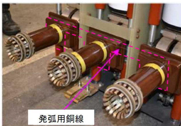
発弧線の設置状況 (遮断器二次側端子)
