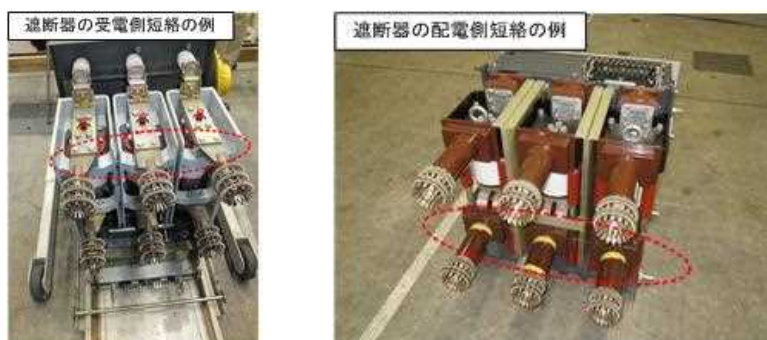
図 4-9 遮断器の短絡箇所 (M/C 試験時)
