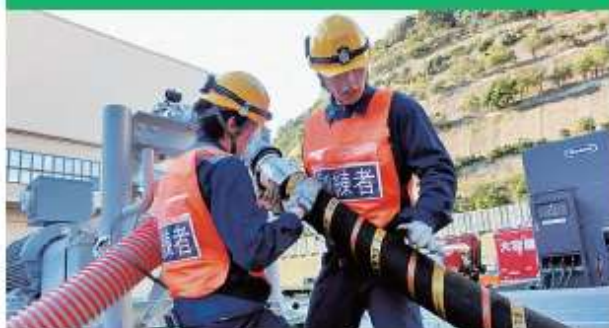
原子炉に冷却水を注入するためのポンプの設置訓練
