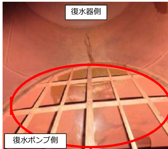
4 B - 復水ポンプ入口ストレーナ
