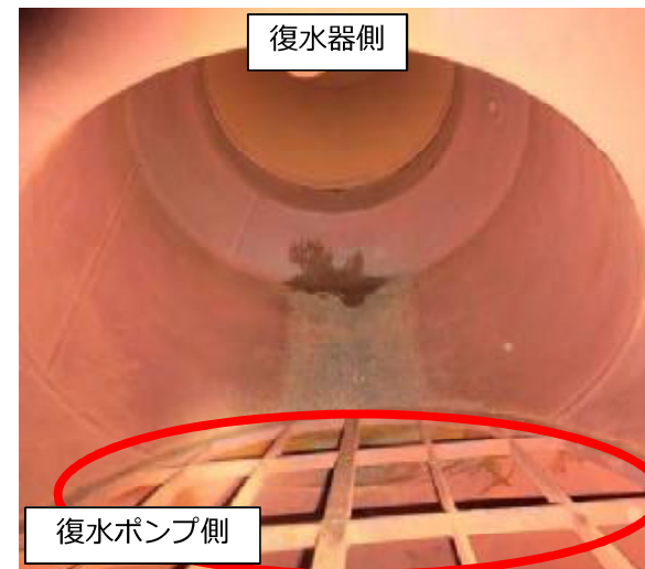
4 C - 復水ポンプ入口ストレーナ
