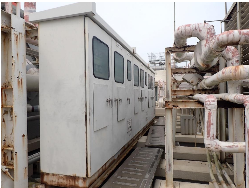
冷却塔 (H81, H82, H83) 制御盤
