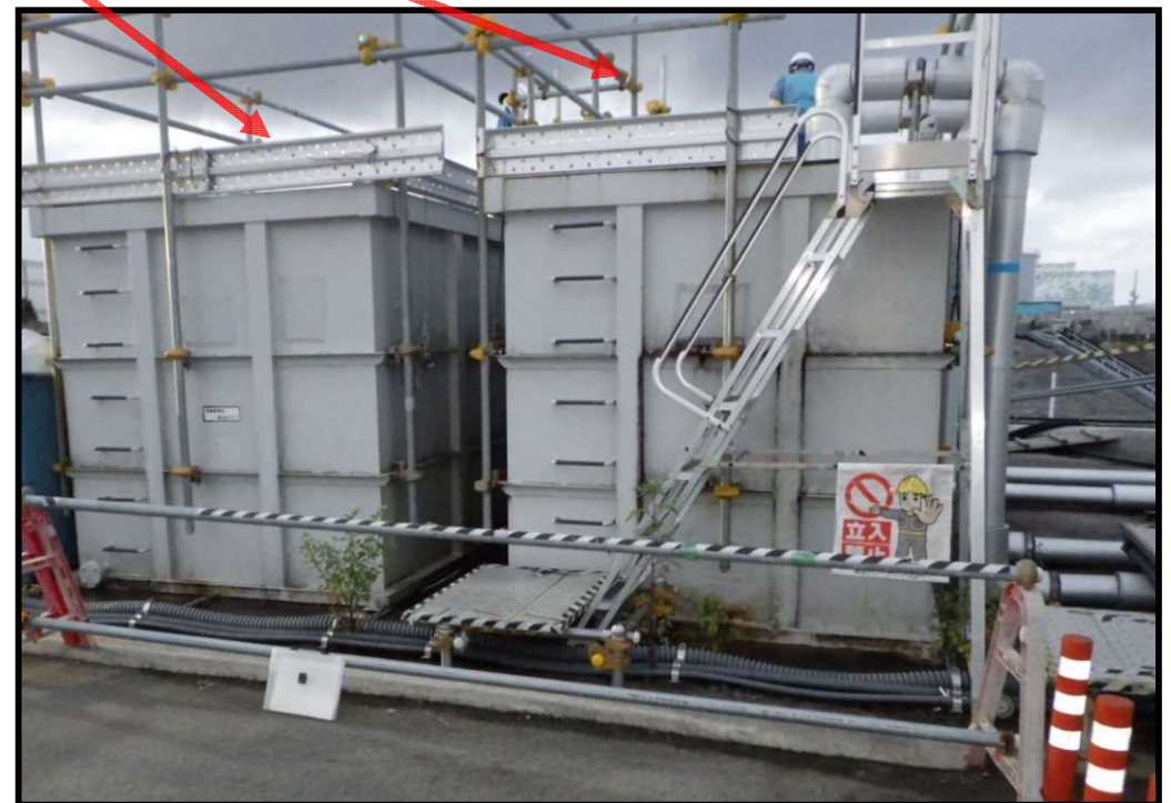
地下水バイパス揚水受タンク (A1,A2)
