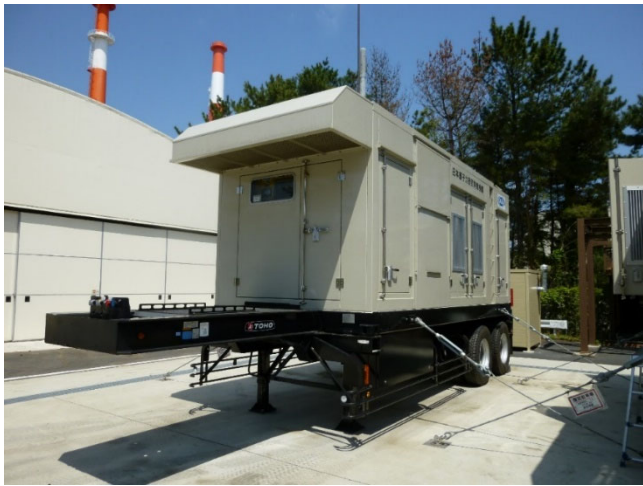
移動式発電機 (PCDF 駐車場)
