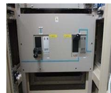
現場（き電盤）にて NFB操作
