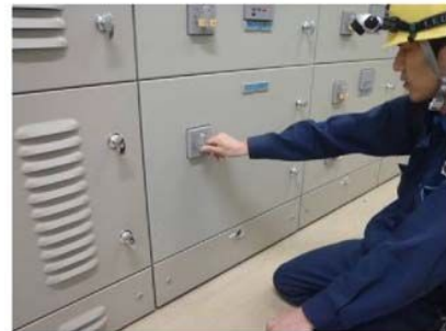
直流電源受電操作 （安全補機開閉器室）
