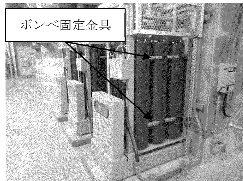
液化炭酸ガス (1号DG建屋)
