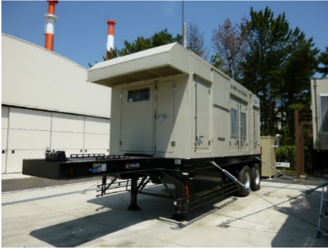
移動式発電機 (PCDF 駐車場)
