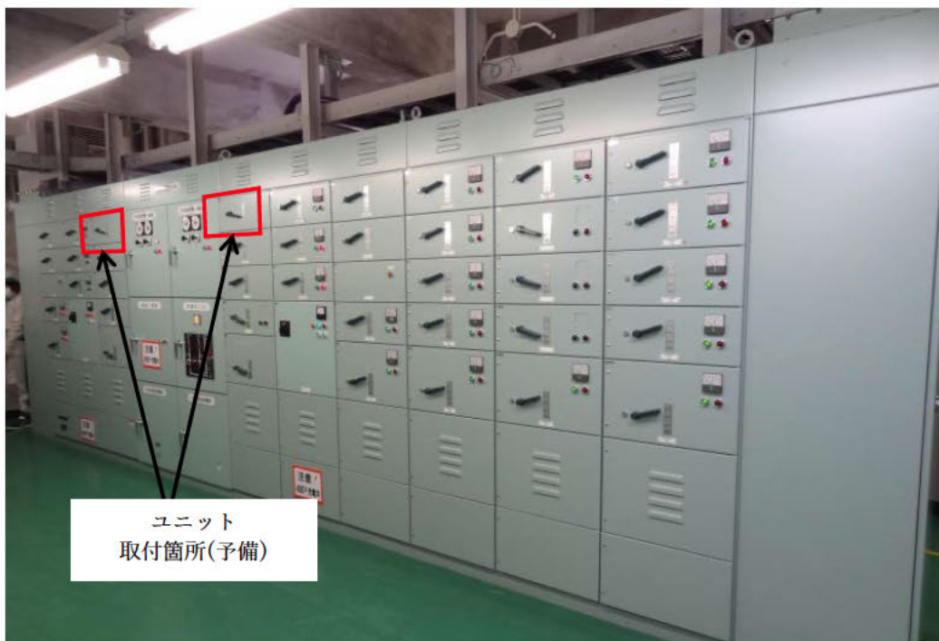
廃溶媒処理技術開発施設の換気・プロセス用動力分電盤
