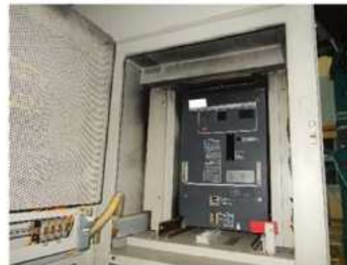
試験後の盤正面の状態
