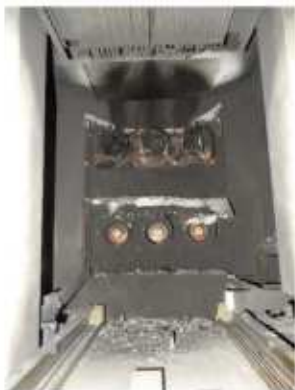
盤内開口部の状態(遮断器室)
