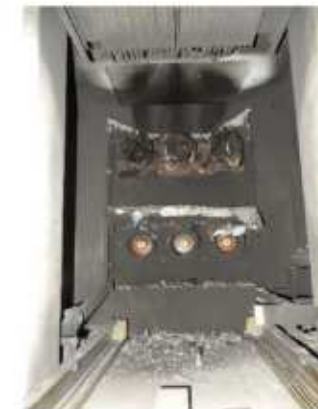
盤内開口部の状態(遮断器室)
