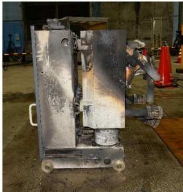
遮断器室アーク発生、アーク火災有、消火後の遮断器の様子
