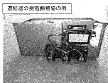
図 4.5.3 遮断器の短絡箇所 (C/C 試験時)
