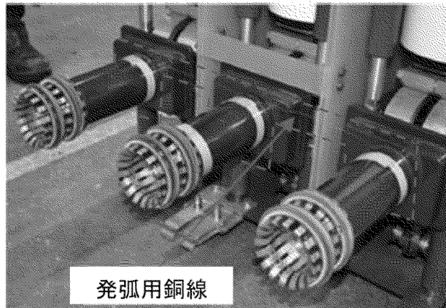
発弧線の設置状況(遮断器2次側端子)
