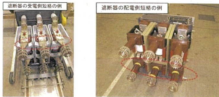
図 4.5.1 遮断器の短絡箇所 (M/C試験時)
