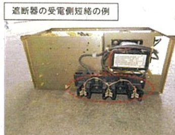
図 4.5.3 遮断器の短絡箇所 (C/C試験時)
