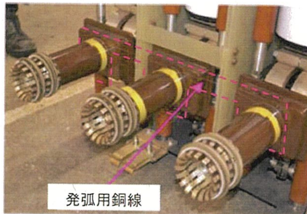
発弧線の設置状況 (遮断器 2 次側端子)
