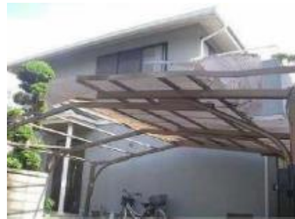
カーボードの被害
