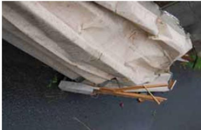
飛散した折板屋根の状況
