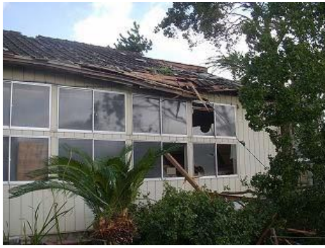
写真 8 倉庫の窓ガラスと屋根の被害状況
