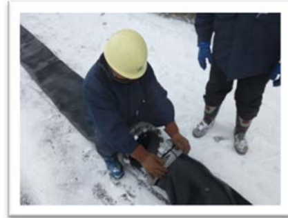
建屋外ホース接続 (300A)
