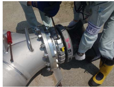
二口分岐接続 (300A×300A×2口)
