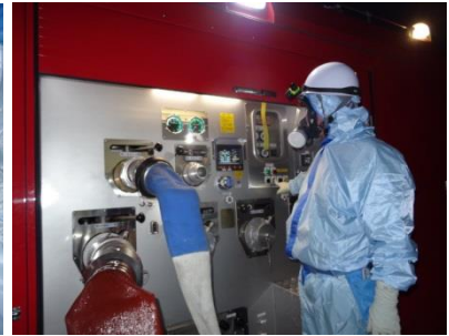
ポンプ起動操作（夜間）
