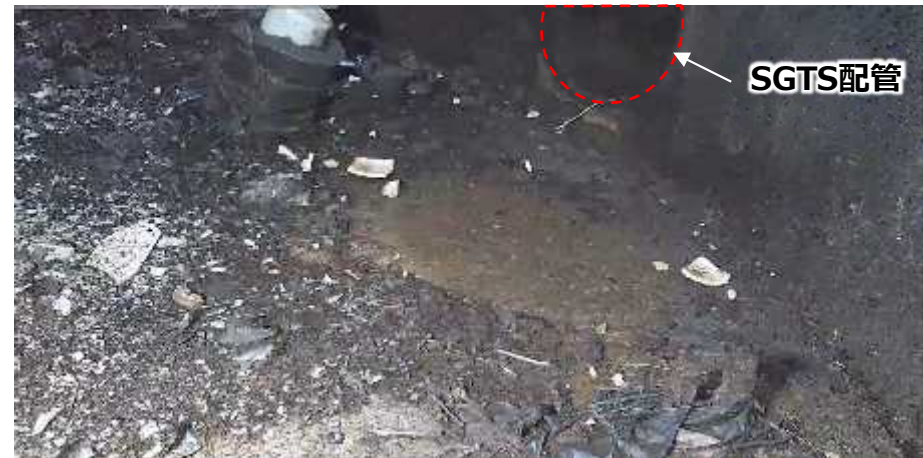
写真：SGTS配管状況(5/20雨天時)
