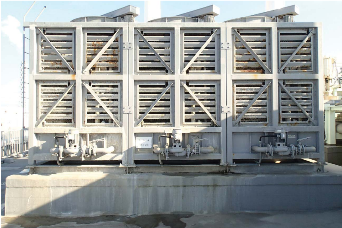
写真-1 冷却塔外観
