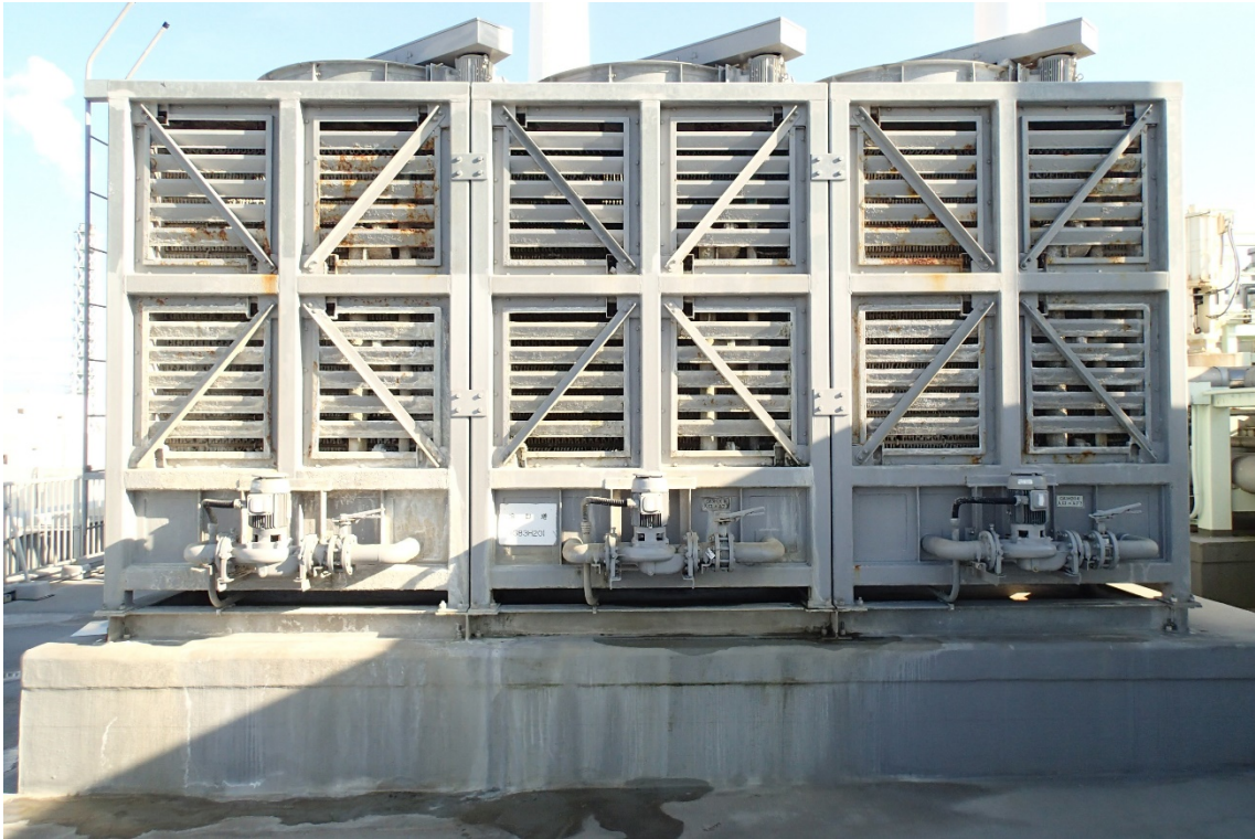
写真-1 冷却塔外観
