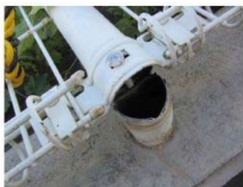
フェンス支柱部の破損
