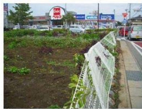
フェンスの変形
