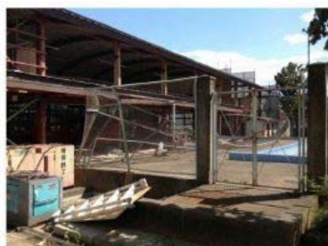
フェンスの変形（工事中の建築物）
