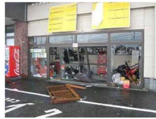
エントランスのガラス損壊
