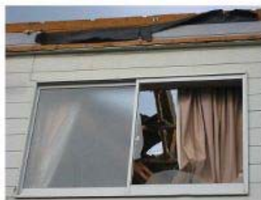
窓ガラスの損壊
