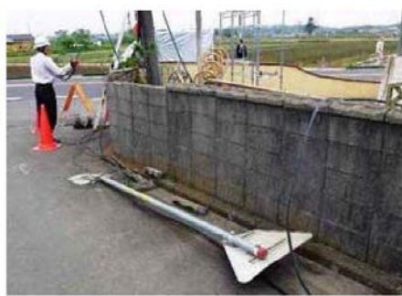
道路標識の倒壊
