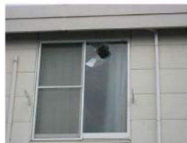
窓ガラスの飛来物衝突痕
