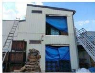
シャッターの外れ
