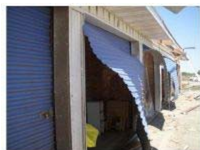
シャッターの外れ
