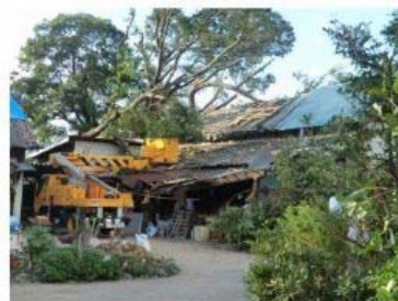
樹木の倒壊による小屋組の被害
