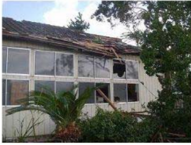
倉庫の窓ガラスと屋根の被害状況
