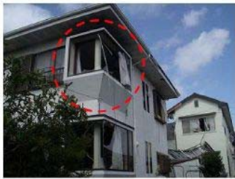
出窓部の窓ガラスの損壊
