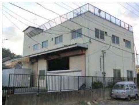
屋上フェンスの変形
