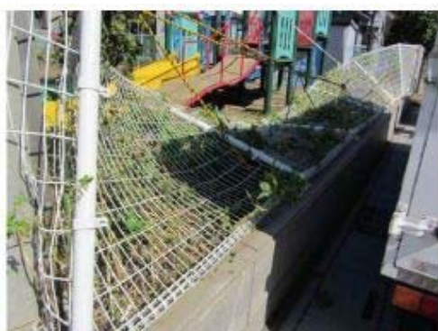
フェンスの変形
