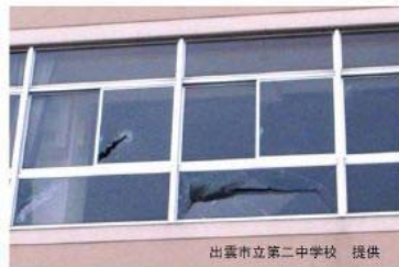
体育館窓ガラスの損壊
