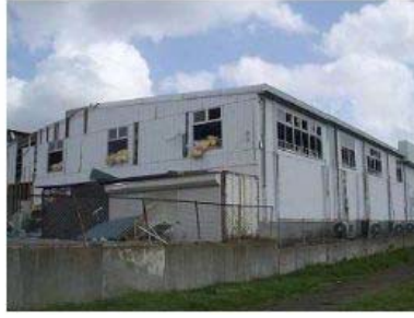
窓ガラスの損壊
