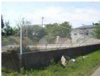
フェンスの変形
