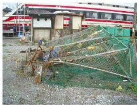
フェンスの著しい変形
