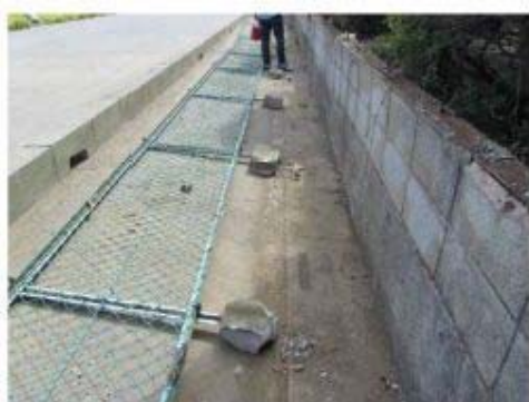
フェンスの倒壊
