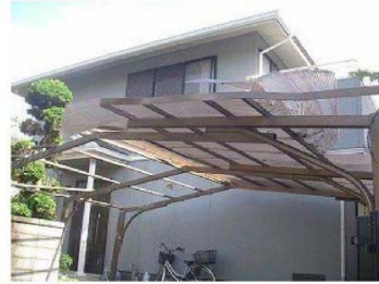
カーポートの被害
