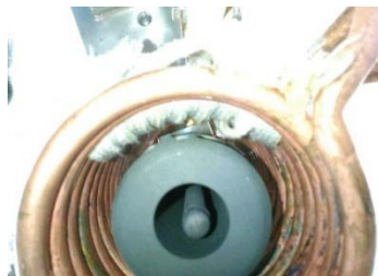
加熱コイル下端からの写真
