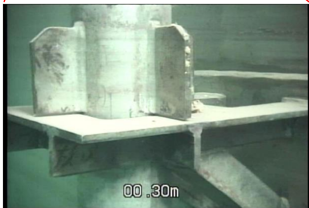
FPC配管サポート (2019/9撮影)
