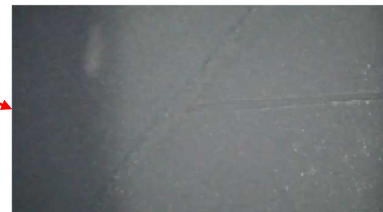
H2-D1タンク内面写真（底板）
