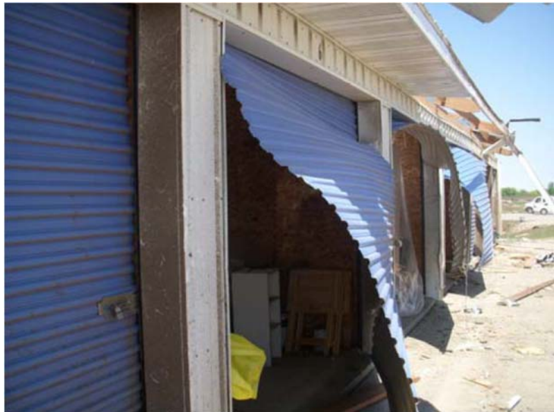
シャッターの外れ
