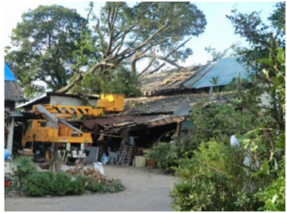
樹木の倒壊による小屋組の被害
