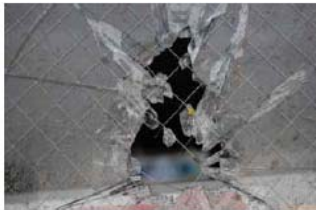
ガラスの被害状況（飛来物衝突痕）
