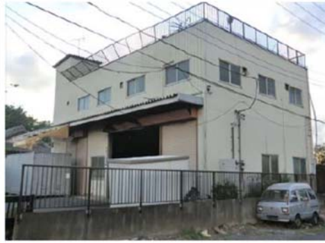
屋上フェンスの変形
