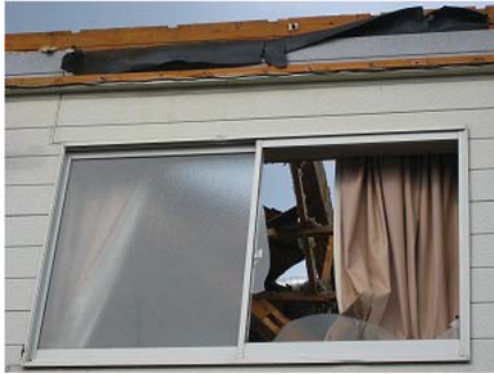
窓ガラスの損壊
