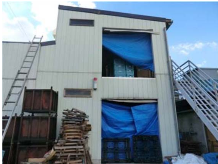
シャッターの外れ
