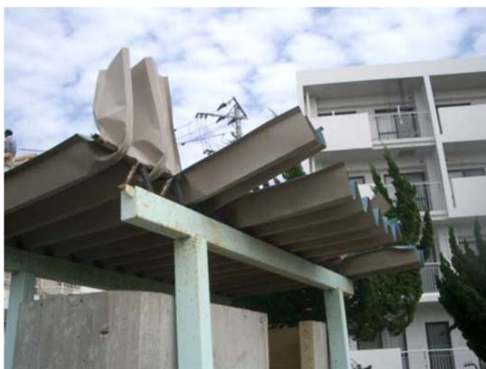
屋外トイレ屋根の損傷
