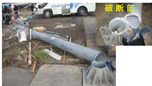
倒壊した道路標識支柱
