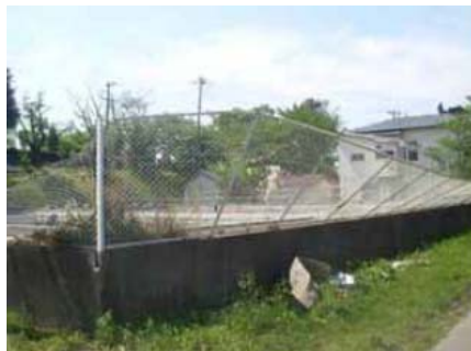
フェンスの変形
