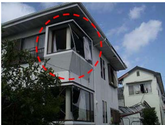
出窓部の窓ガラスの損壊
