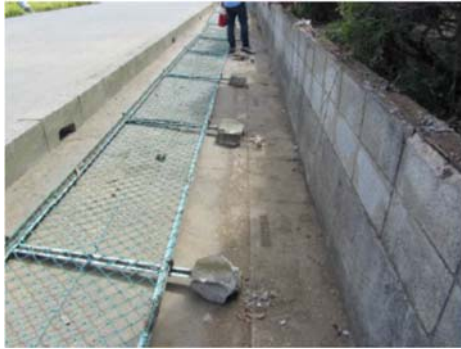
フェンスの倒壊
