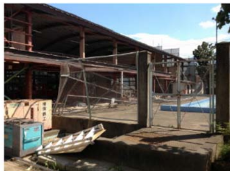
フェンスの変形（工事中の建築物）
