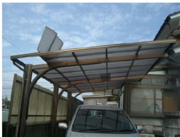
カーポート屋根の損傷
