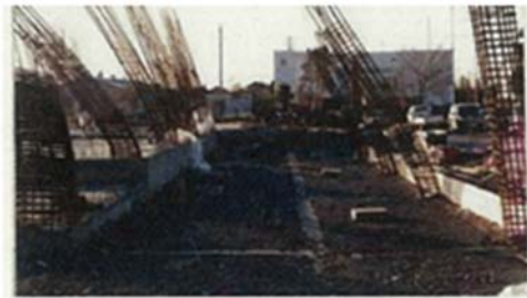
曲がった鉄筋(工事現場)
