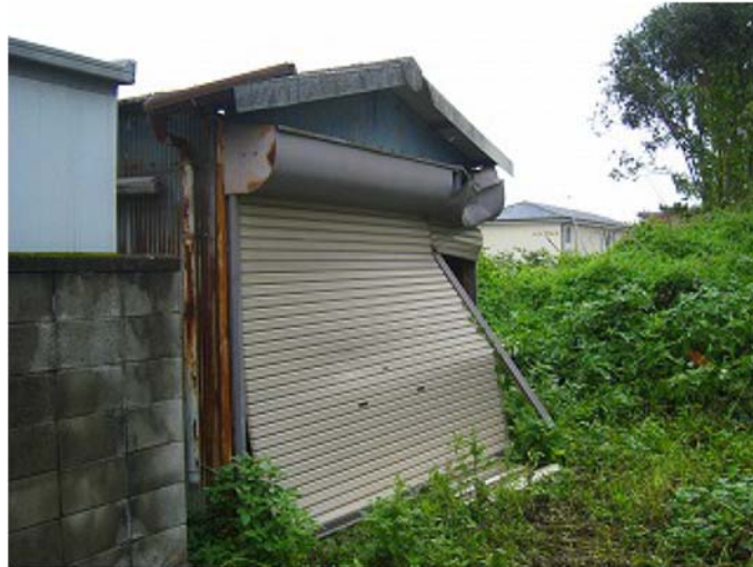
シャッターの外れ
