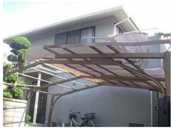
カーポートの被害
