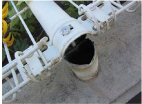
フェンス支柱部の破損
