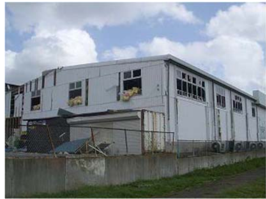
窓ガラスの損壊
