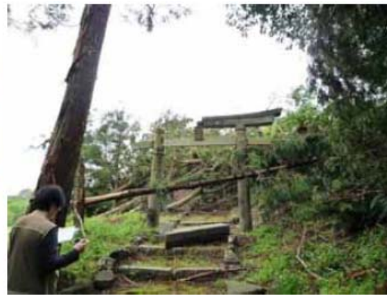
樹木の折損と鳥居の被害
