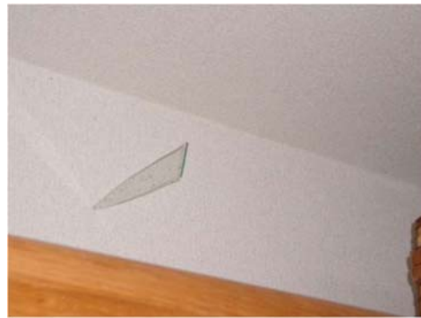
破損した窓ガラス片の 屋内壁面への突き刺さり
