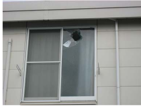
窓ガラスの飛来物衝突痕
