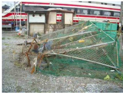
フェンスの著しい変形
