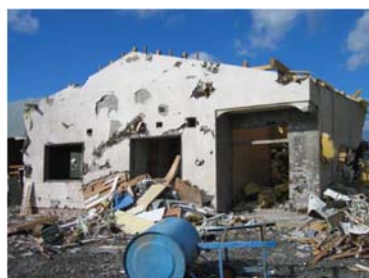
飛来物による被害を受けた建物
