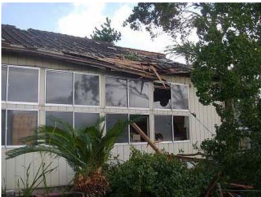
倉庫の窓ガラスと屋根の被害状況
