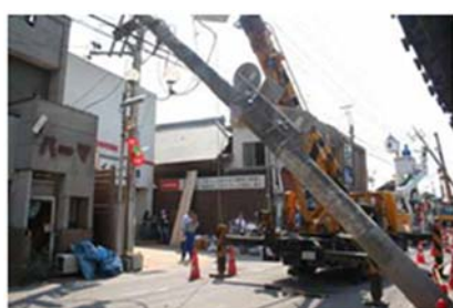
倒れた電柱(復旧作業時)
