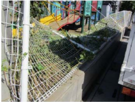
フェンスの変形
