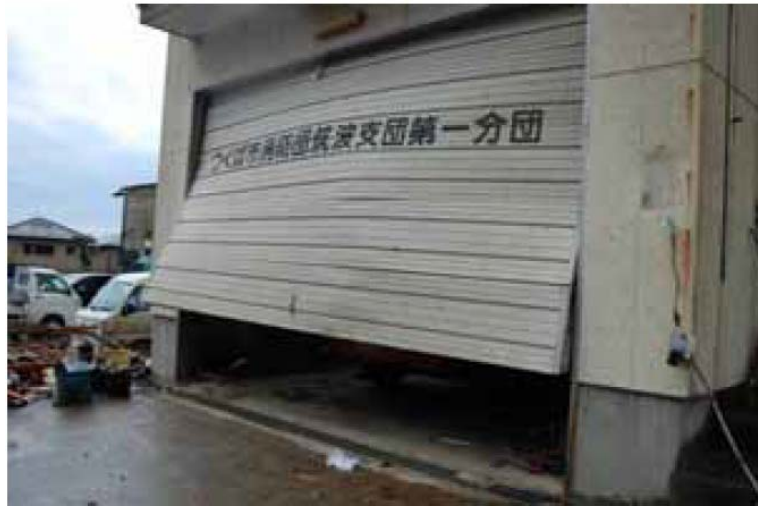
消防団施設のシャッターの変形
