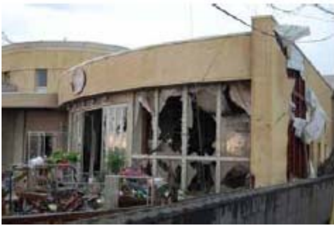
店舗の窓ガラスの被害状況
