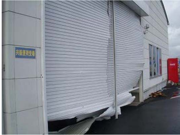
シャッターの変形
