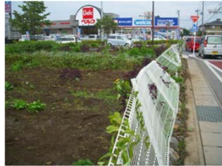
フェンスの変形
