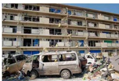
飛来物により被害を受けた住宅等
