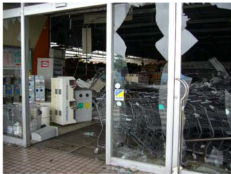
エントランスの窓ガラスの破損
