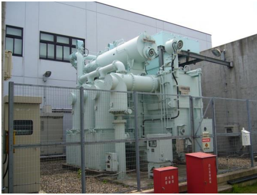
1号受電変圧器
