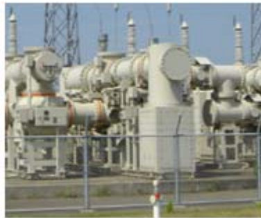
第 3-2-2 図 受変電設備のフェンス (小動物対策)
