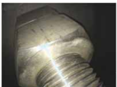
272V36（予備貯槽）のアンカーボルトの状況
