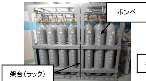
高浜3号機 外周建屋 ハロン1301 (消火設備)
