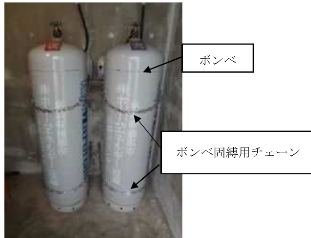
3, 4号炉 補助ボイラプロパン室 補助ボイラ用プロパンガス
