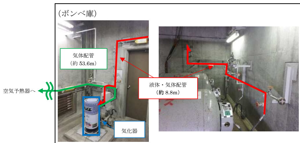
図 3・4号機雑固体焼却設備のプロパンポンベ加温器回りの現場状況
