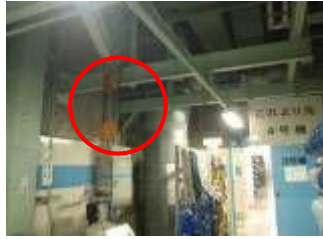
【作業用ホイスト】 落下した場合であってもアクセス性に問題ないことを確認 また可能な限りアクセスルート上部を外れた位置に移動している
