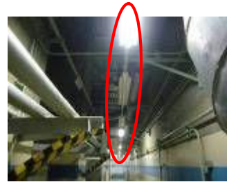
【最も大きな照明器具】 落下した場合であってもアクセス性に問題がないことを確認
