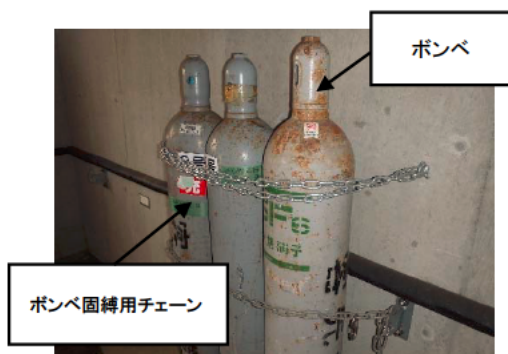
【3号炉ガス倉庫】
