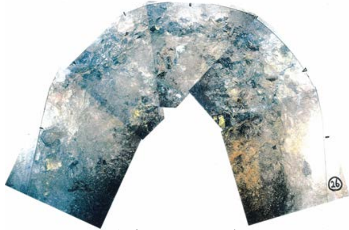
側壁(上半)No.26 写真
