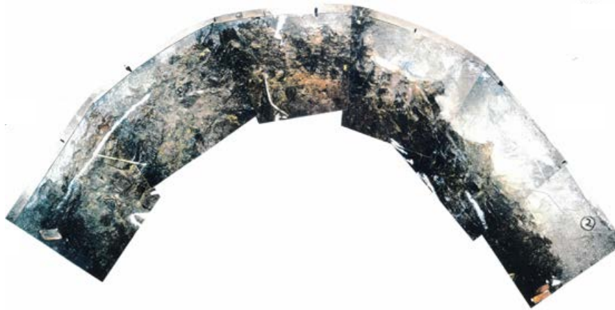
側壁(上半)No.2 写真
