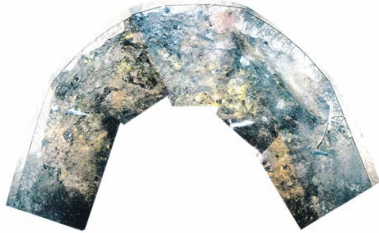
側壁(上半)No.45 写真
