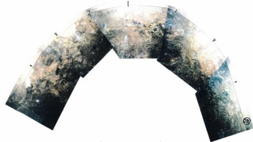
側壁(上半)No.28 写真
