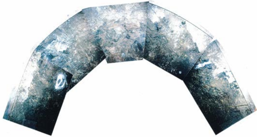
側壁(上半)No.53 写真
