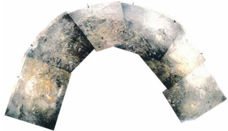
側壁(上半)No.4 写真
