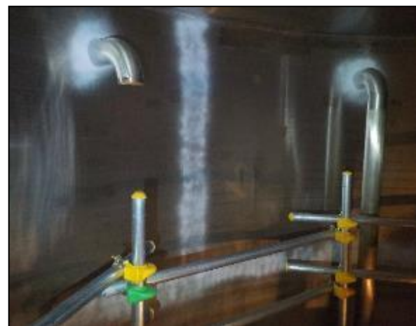
④機器ドレン廃液受タンク(B)
