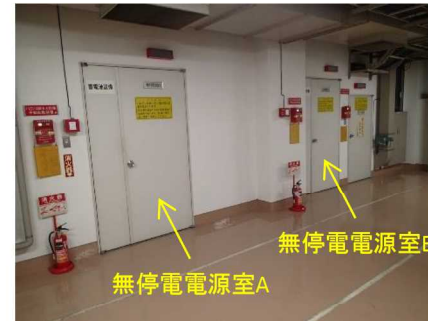
無停電電源室A、B
