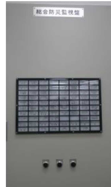
総合防災監視盤
