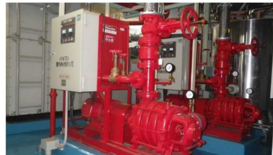
屋内消火栓ポンプ
