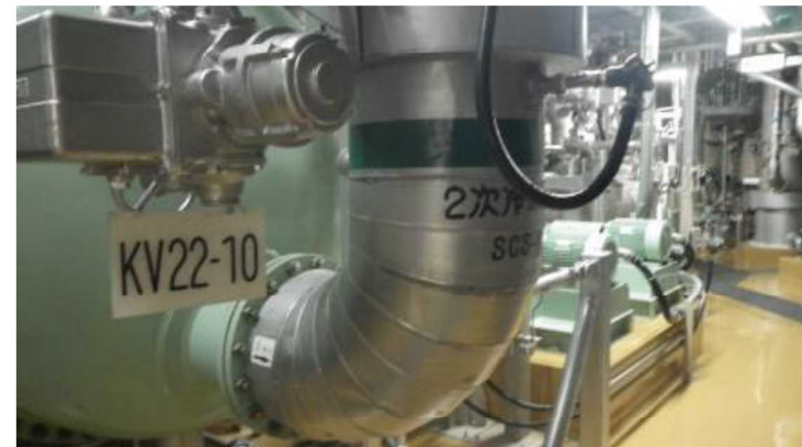
グラスウールを使用した2次冷却系保温材
