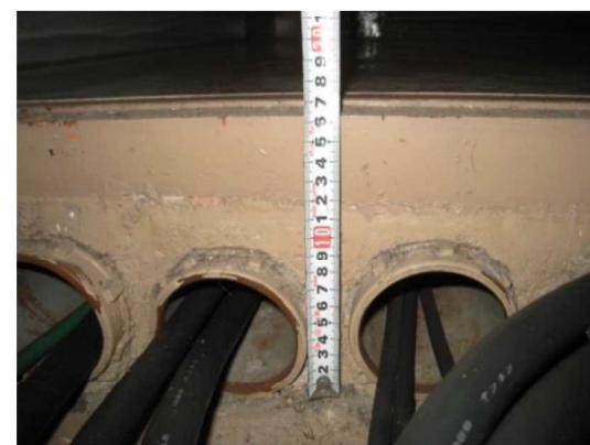
非常用電源系B系の電線管
