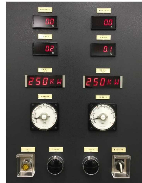
中央制御室中性子計装設備の監視計器
