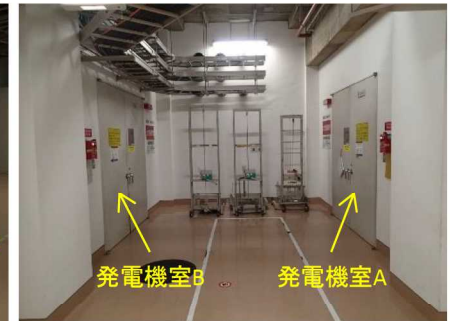
発電機室A、B
