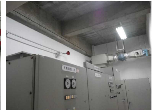
ハロン消火剤噴出口
