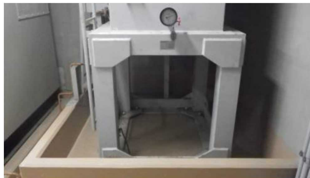
非常用発電機燃料油漏えい防止のための堰
