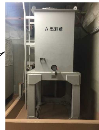
非常用発電機燃料 A重油 970L/基
