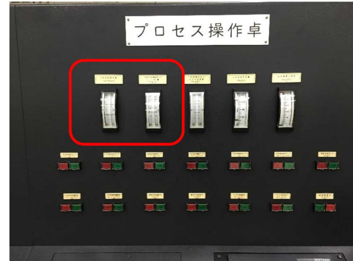
中央制御室プロセス計装設備の監視計器
