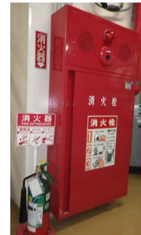
屋内消火栓及び消火器
