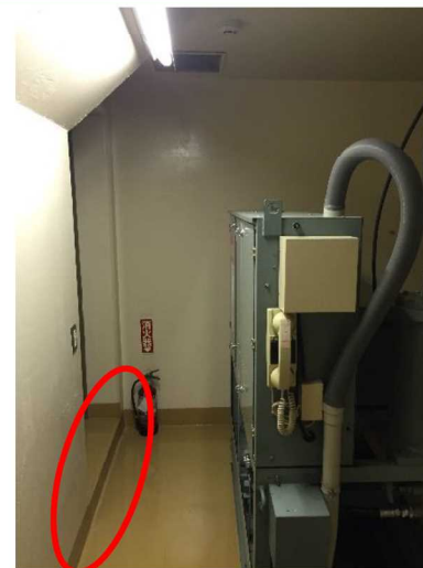
エレベータパワーユニット作動油漏えい防止のための段差
