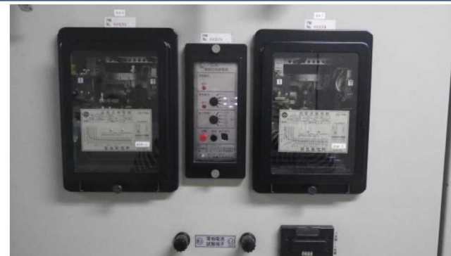
過電流継電器及び地絡継電器
