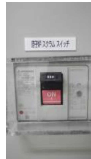
中央制御室外原子炉停止盤の 原子炉スクラムスイッチ
