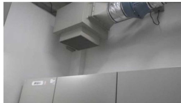
蓄電池の水素ガスの換気設備
