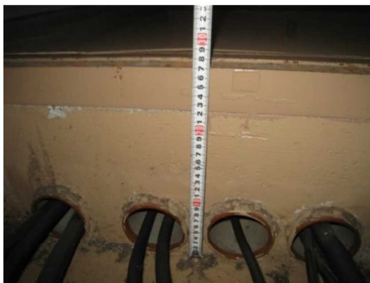
非常用電源系A系の電線管
