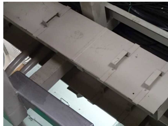
蓋付きケーブルトレイにより分離されたケーブル
