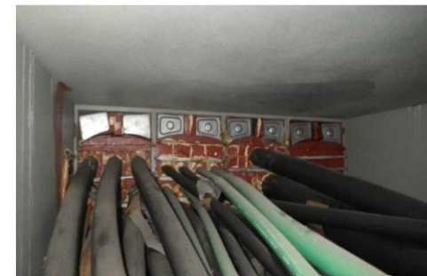
ケーブル貫通部
