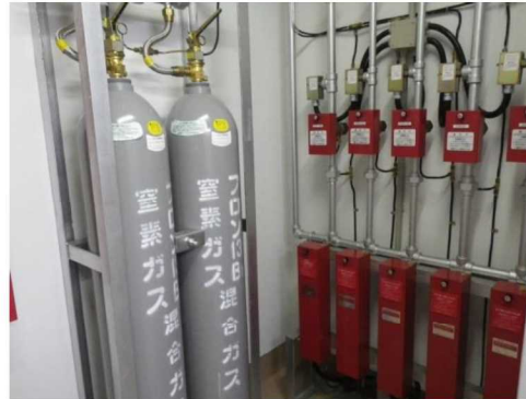
ハロン消火設備
