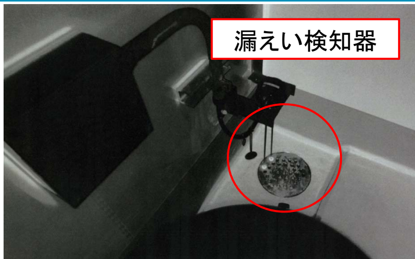
第1図 漏えい検知器 施工例
