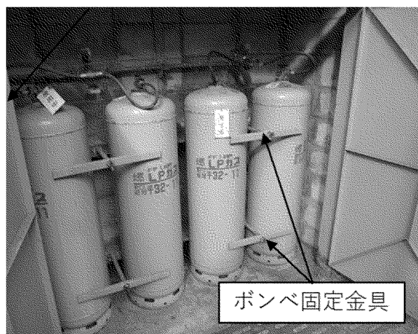
図 LPガスボンベ保管状況（1,2号補助ボイラ起動用）
