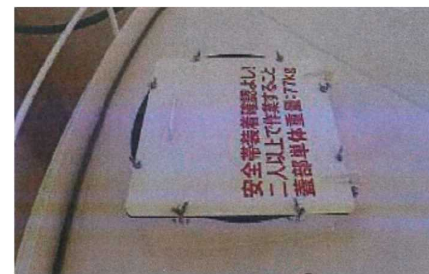
③マンホールパッキンはみ出し
