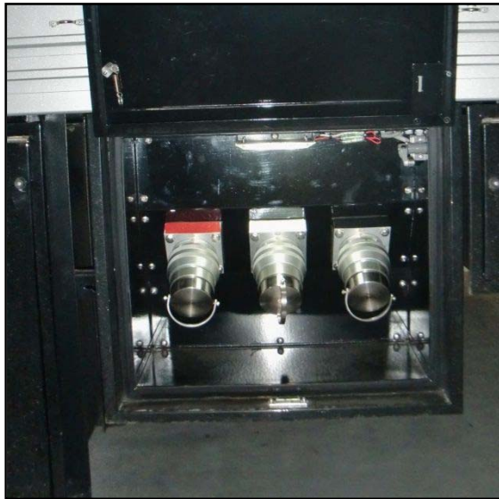
高圧ケーブル接続箇所（共通電源車）
