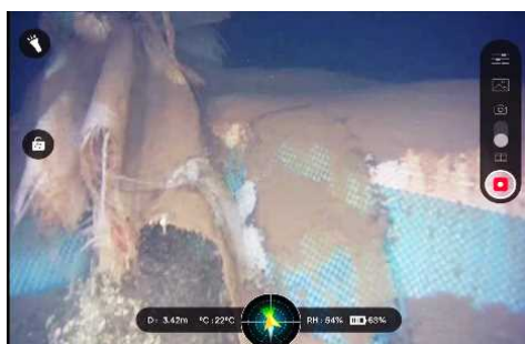
破損している土嚢
